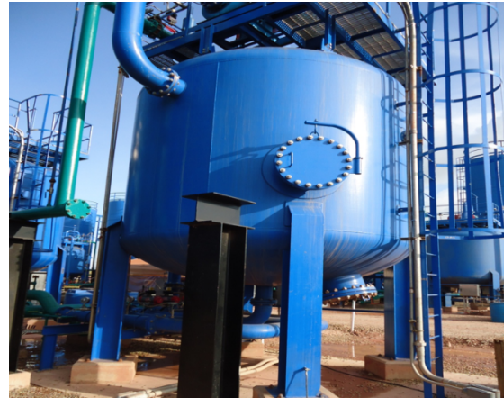
Fig. 7. Filtro de lecho vegetal.
