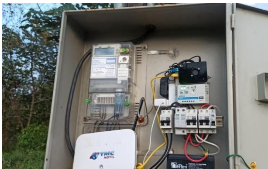
Fig. 5. Prototipo funcional instalado en Mitú (Vaupés) Fuente: elaboración propia
