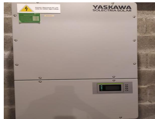
Fig. 2. Inversor solar No 1 de la planta.
