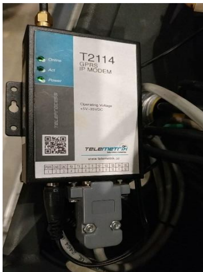
Fig. 6. Sistema de comunicaciones del inversor. Fuente: elaboración propia.
