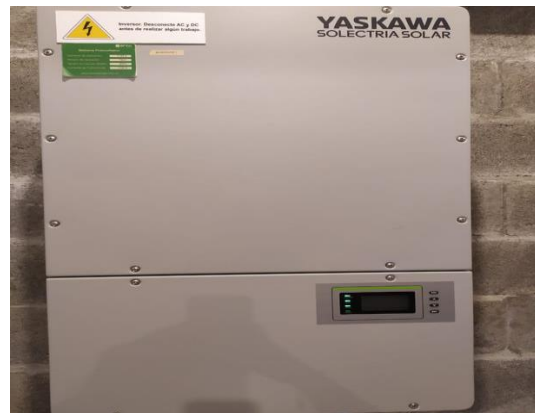
Fig. 2. Inversor solar No 1 de la planta.
