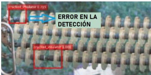
Fig. 1. Sistema de detección reconoce una falla erróneamente en un aislador de las líneas eléctricas de alta tensión. Fuente: (Li et al., 2017).
