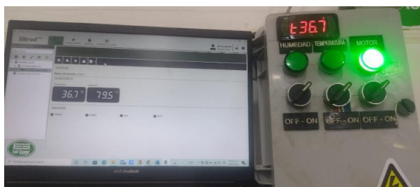
Fig. 17. Valor T equipo gerenciamiento y tablero de control
