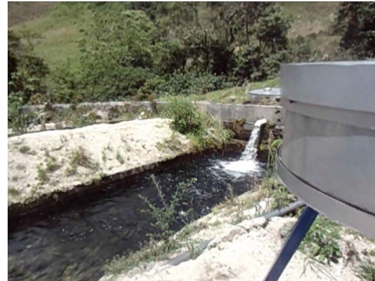
Fig. 10. Sistema en funcionamiento
