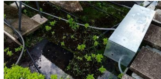
(c) Caja de válvula de agua.
