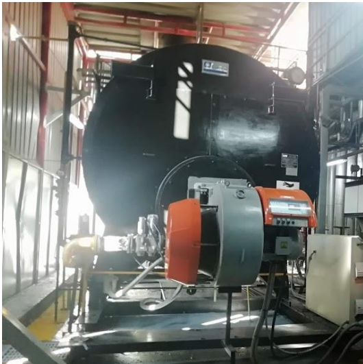
Figura 1 caldera de 700 HP – Planta de coca cola Fuente: Autor(es)
