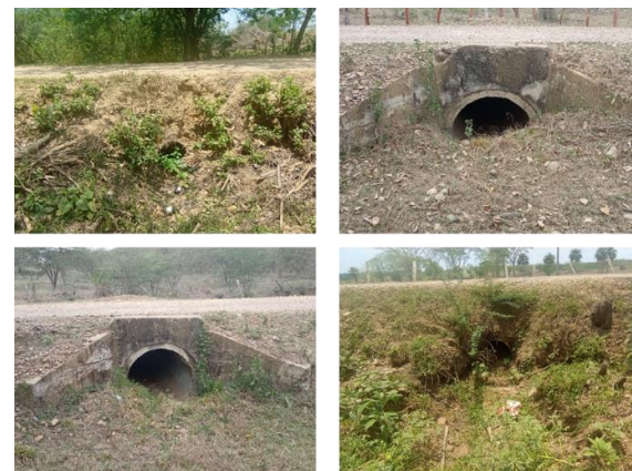
Figura 5. Alcantarillas parcialmente tapadas
