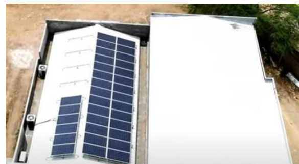
Figura 3. Vista aérea de los paneles FV instalados en la cubierta de la planta piloto Power to Gas
