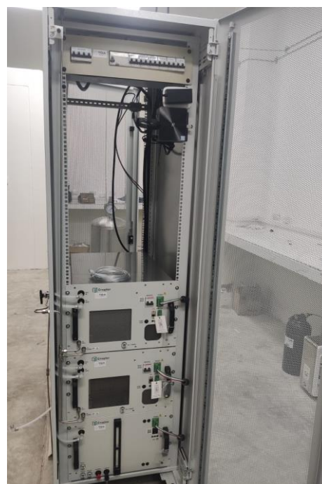
Figura 4. Fotografía de los electrolizadores EL 2.1 y sistemas auxiliares de la marca Enapter ubicado en la planta piloto Power to Gas.
