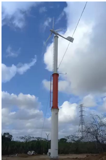
Figura 2. Fotografía de la instalación de aerogenerador Aeolos-H 5 kW instalado en las cercanías de la planta piloto Power to Gas.
